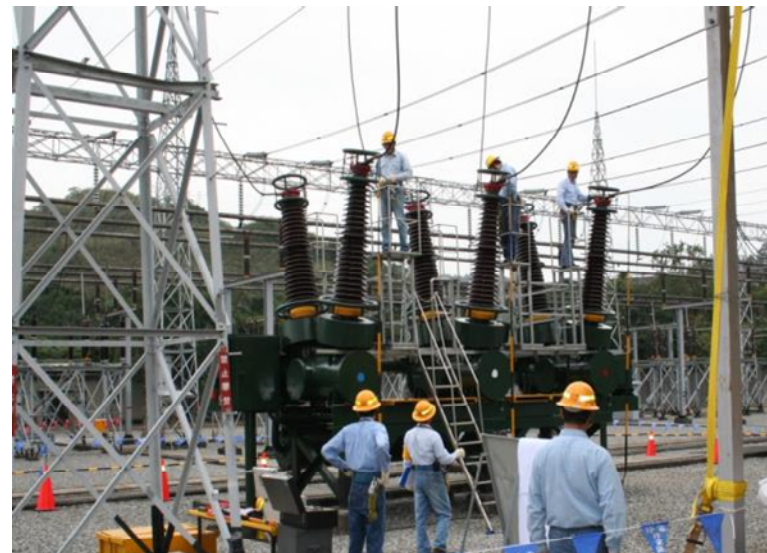
屋外式斷路器檢修
