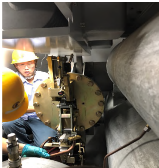
屋內式斷路器檢修
